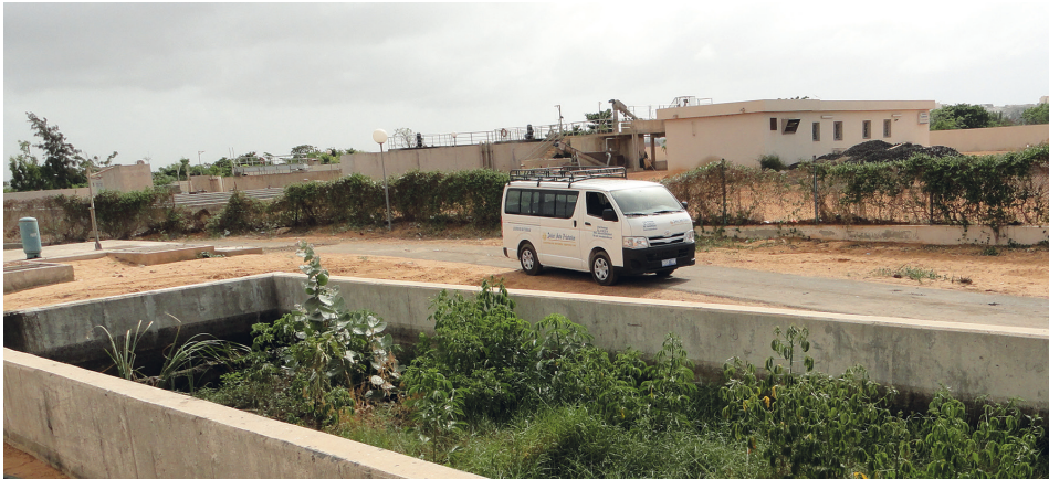
Figure 6.5 : Exemple d'exploitation-maintenance inadaptée d'un bassin de décantation et d'épaississement en Afrique de l'Ouest. La couche d'écume qui n'a pas été extraite depuis longtemps sert de support au développement de végétaux. Les volumes de boues et d'écume accumulés dans l'ouvrage ne permettent plus d'atteindre la performance escomptée et nécessitent des moyens plus importants pour le nettoyage (photo : Sandec).
