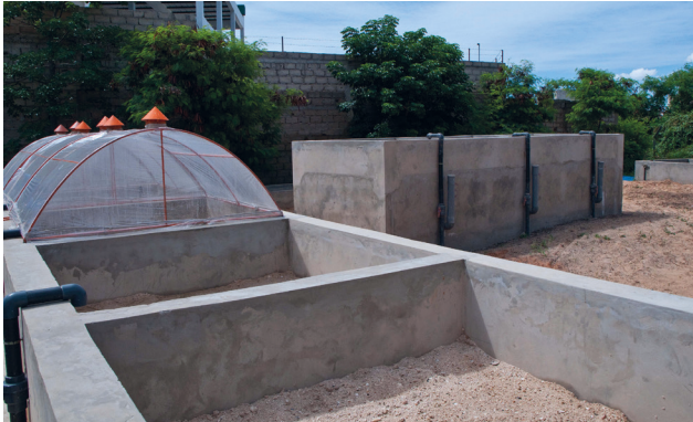
Figure 7.7 : Installation pilote à la station de traitement de Cambéréne, Dakar, Sénégal, pour évaluer la dés-hydratation possible avec ventilation passive et active, sous serre (photo : Linda Strande).
