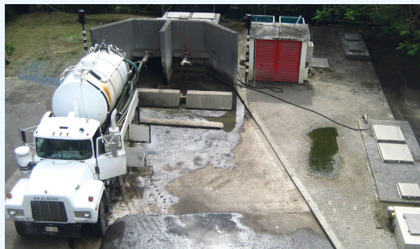
Figure 9.10 : Dépotage de boues de vidange à la station d'épuration d'Illidge Road, au niveau du bassin tampon.
