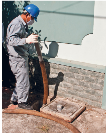
Figure 4.3 : Exemple de regard de visite d'une fosse septique conçue pour permettre un accès rapide, Vung Tau Province, Vietnam (photo : Linda Strande).
