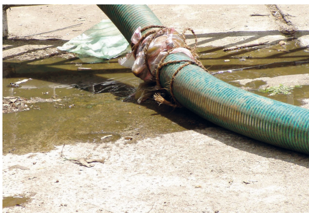
Figure 4.4 : Les tuyaux et accouplements doivent être régulièrement contrôlés et changés. Sur cette photographie, des boues fuient car la connexion n'est plus étanche (photo : David M. Robbins).
