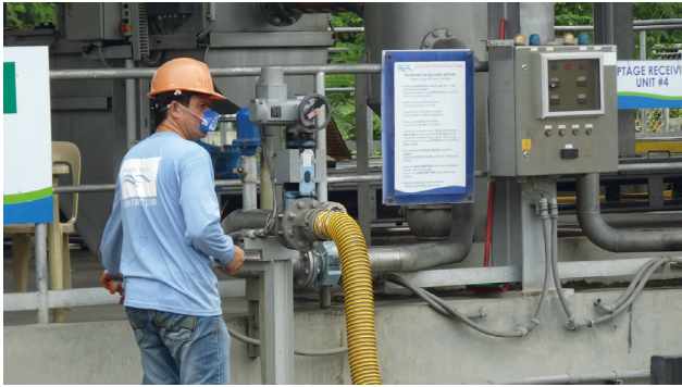
Figure 4.16 : Unité de dépotage mécanisée au niveau de la station d'épuration South Septage de la société Manila Water, à Manille, aux Philippines (photo : WSUP, Sam Parker).
