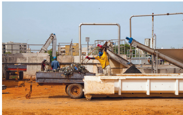
Figure 11.1 : Un ouvrier de maintenance nettoie les dégrilleurs mécaniques ; cette activité essentielle doit être réalisée à chaque dépotage pour assurer le fonctionnement du système. Dakar, Sénégal (photo : Linda Strande).
