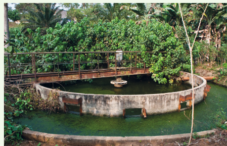
Figure 17.3 : Station d'épuration non-fonctionnelle à Yaoundé, Cameroun (photo : Linda Strande).
