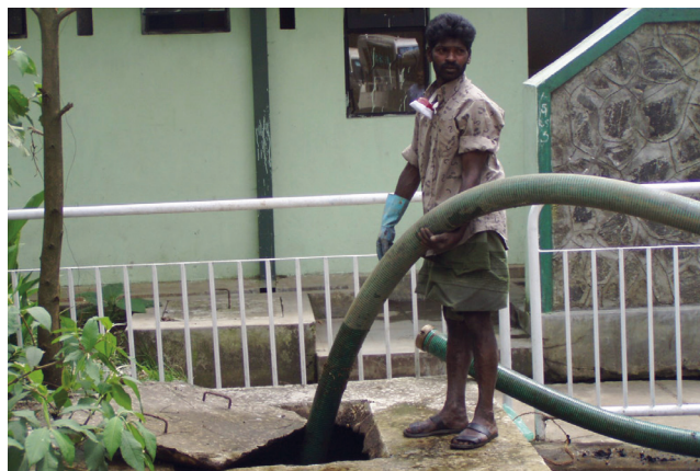
Figure 4.1 : Vidange d'une fosse septique à l'aide d'un équipement d'aspiration sous vide. La sécurité des opérations serait meilleure avec des équipements de protection mieux adaptés (photo : David M. Robbins).
