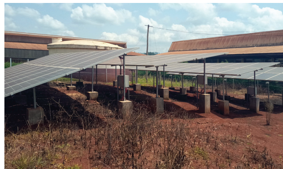
Centrale solaire créée à l'hôpital de Bangangté
