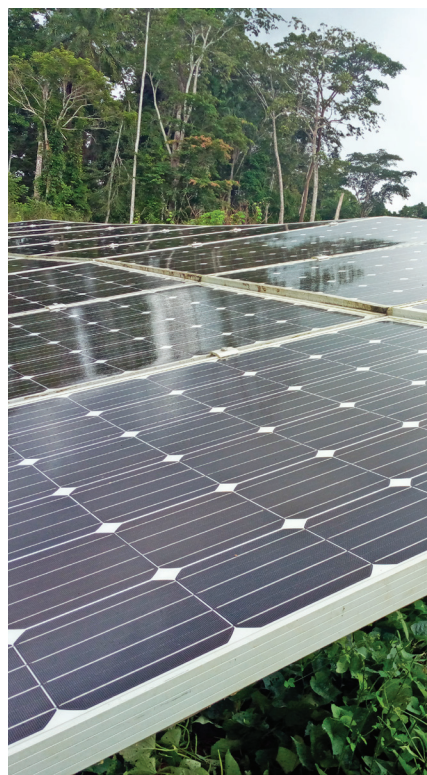
Panneaux solaires installés à Afanloum
