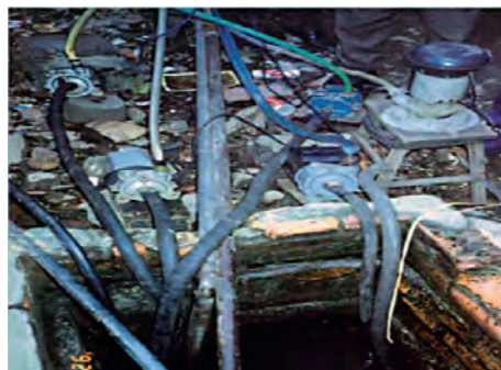
Des branchements illégaux sont réalisés directement sur le réseau souterrain. Illegal connections are made directly on the underground network. ការតភ្ជាប់ទឹកដោយខុសច្បាប់ចេញពីប្រព័ន្ធគ្រោមដីផ្ទាល់
