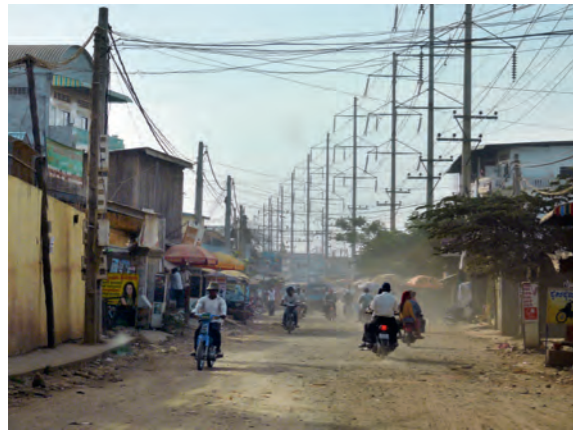
La nouvelle ligne à haute tension le long de la rue Oknha Mong Reththy, 2009 The new high-voltage line along Oknha Mong Reththy Street, 2009.
