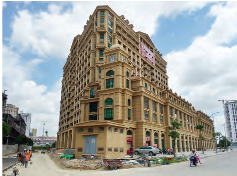
Ile de Koh Pich, immeuble de logement de style néo-classique en construction, Phnom Penh, 2018.
