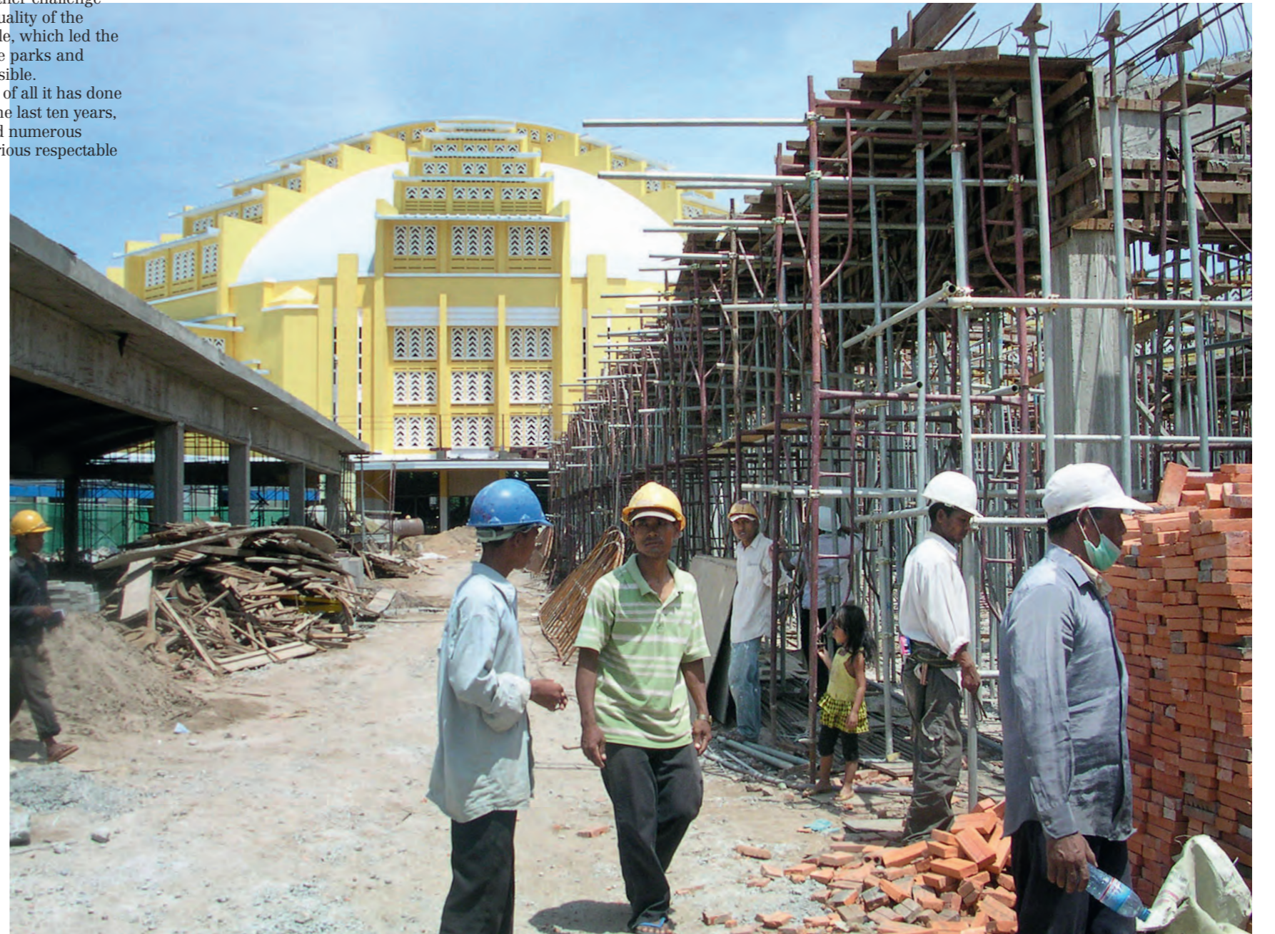
Le chantier de rénovation du Marché Central, 2009 / The Central Market renovation work site, 2009. / ការដ្ឋានជួសជុលផ្សារធំថ្មី ឆ្នាំ២០០៩
